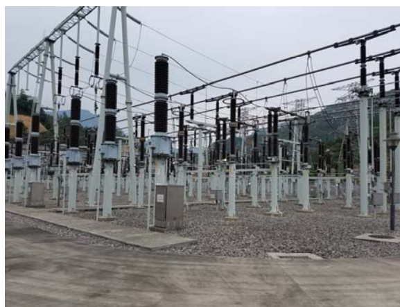
220kV 户外配电装置区
