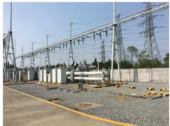
110kV 户外配电装置
