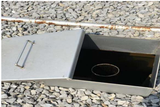
污水处理装置（近景）
