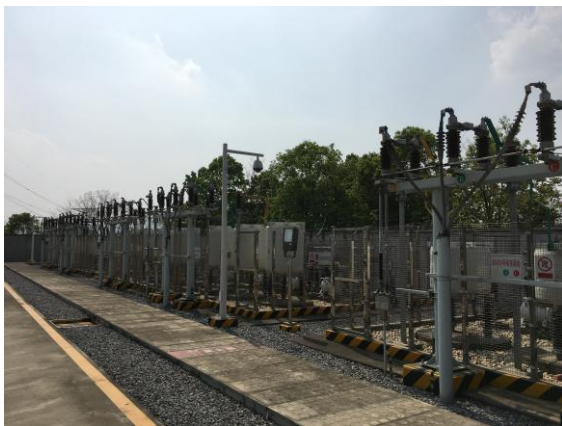
35kV 户外配电装置
