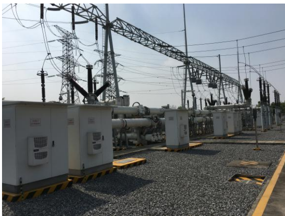
220kV 户外配电装置
